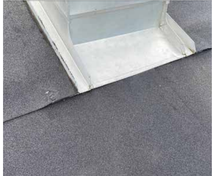
Am Dach eines Privathauses in Schwendt löste sich die Bitumenbahn im Bereich von An- und Abschlüssen vom Blechuntergrund. Durch partielle Reparaturen mit einer Flüssigabdichtung sollte die Dichtigkeit wiederhergestellt werden.
