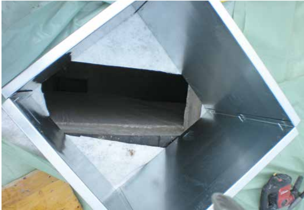
Bild 1: Der Leitungsschacht ist versetzt, jedoch fehlen die anzubindenden Leitungen und nötigen Platzverhältnisse, um dies auch fachgerecht umzusetzen.
