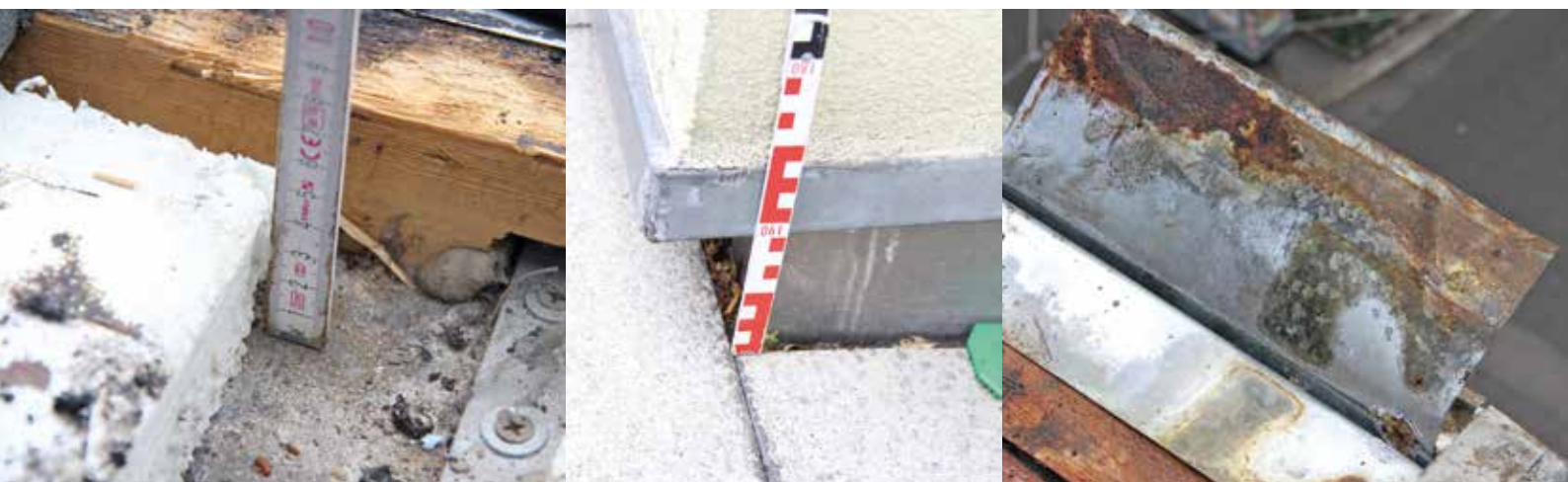
Bild 4: Die Dicke der Wärmedämmung beträgt 4 cm. | Bild 5: Die Höhe der Wandanschlüsse liegen 15 cm unter der Oberkante des fertigen Terrassenbelagniveaus. | Bild 6: Korrodierte Verblechung im Bereich des Patensaumstreifens entlang der Traufenbohle.
