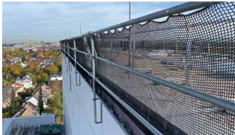
Die Sifatec-Mitarbeiter installierten rund 160 Meter ihrer bewährten Industriekonsole. Der Seitenschutz wurde zusätzlich mit engmaschigen Netzen versehen.
