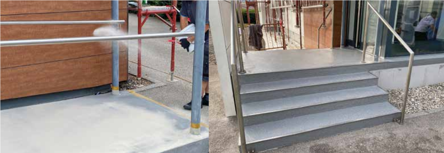
Bild links: Um eine hohe Rutschfestigkeit zu erreichen und den Zugangsbereich der Raiffeisenbank dauerhaft sicher nutzbar zu machen, haben die Sanierungsexperten die Fläche der Rampe sowie der Treppe mit Triflex Cryl Finish 205 versiegelt. In das noch frische Harz streuten sie Quarzsand in feiner Körnung überschüssig ein. Bild rechts: Nach nur drei Tagen waren die Sanierungsarbeiten in Schwand abgeschlossen. Das Ergebnis ist ein optisch ansprechender Eingangsbereich, der ein gefahrloses Begehen selbst bei winterlicher Witterung ermöglicht.
