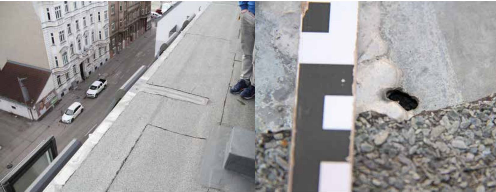
Bild 3: Die vor einem Jahr sanierte Traufenausbildung, Übergang Flachdach zu Steildach. | Bild 4: Die offensichtlich nachträglich herbeigeführte mechanische Beschädigung in der neuen Traufenverblechung, die zu neuerlichen Nässeschaden geführt hat.
