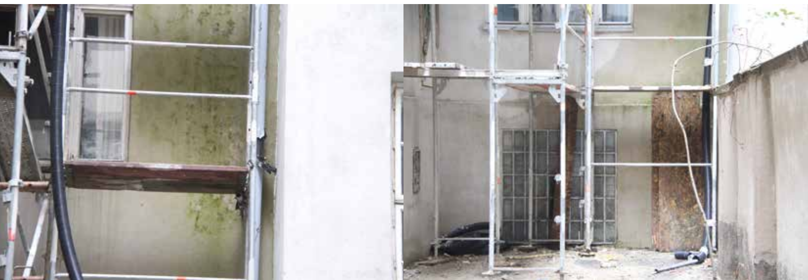
Bild 1: Die Innenhoffassade mit dem Gerüst und die erhebliche Vermoosung an der Wandfläche, da hier das Wasser unkontrolliert abläuft.
